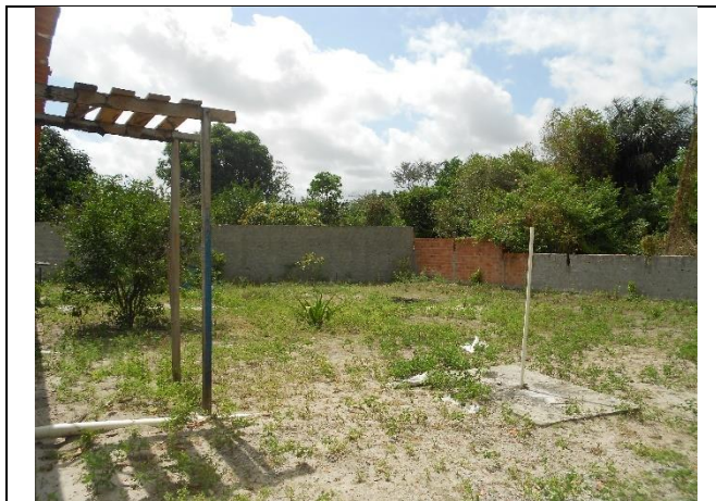
Foto - Muro inacabado da escola, Humberto de Campos (MA), Povoado Onça, em 15/09/2016.
