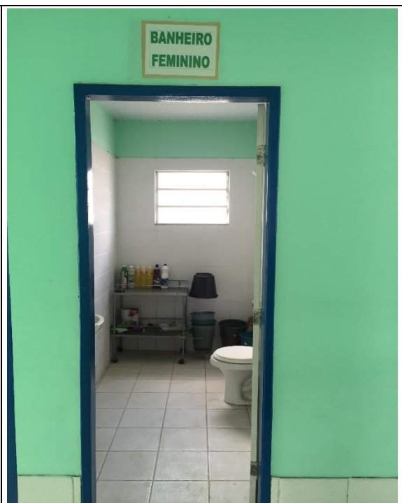
Foto 4 – Banheiro feminino da UBS de Peria, que também é utilizado como depósito de material de limpeza. Humberto de Campos (MA), 12 de setembro de 2016
